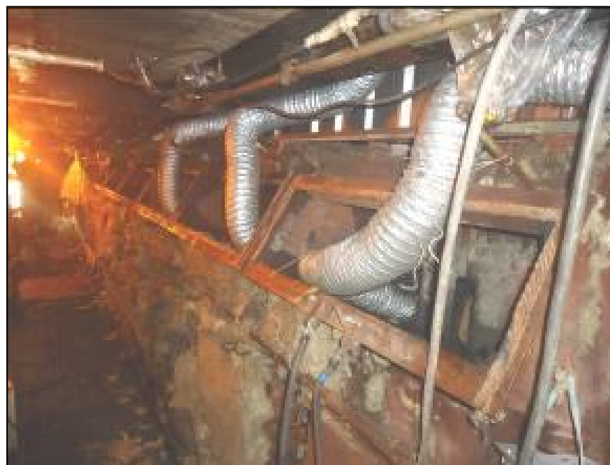
Alimentação de ar para pressurização da câmara
