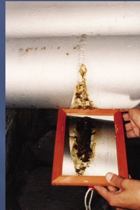
Corrosão no componente tubular com perfuração localizada na parte inferior do cordão de solda.
