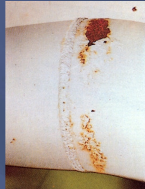
Corrosão em tubulação em área próxima à solda.
