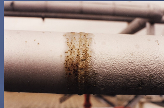
Corrosão predominante na área de solda do componente tubular do pipe-rack.
