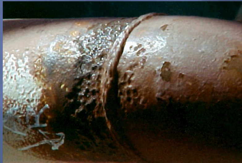
Corrosão em área próxima à solda
